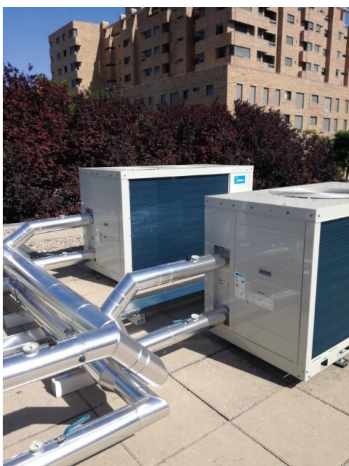
Foto 2.- Otras 2 enfriadoras situadas en cubierta
