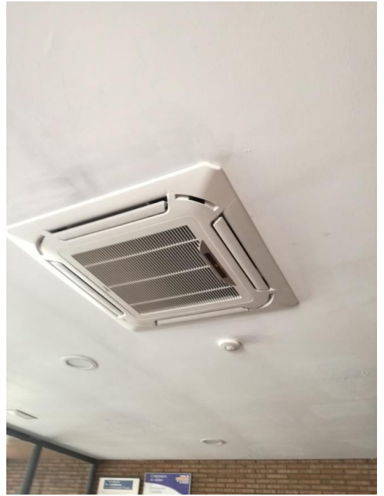
Fotos 7.- Equipo interior en Zona de entrada
