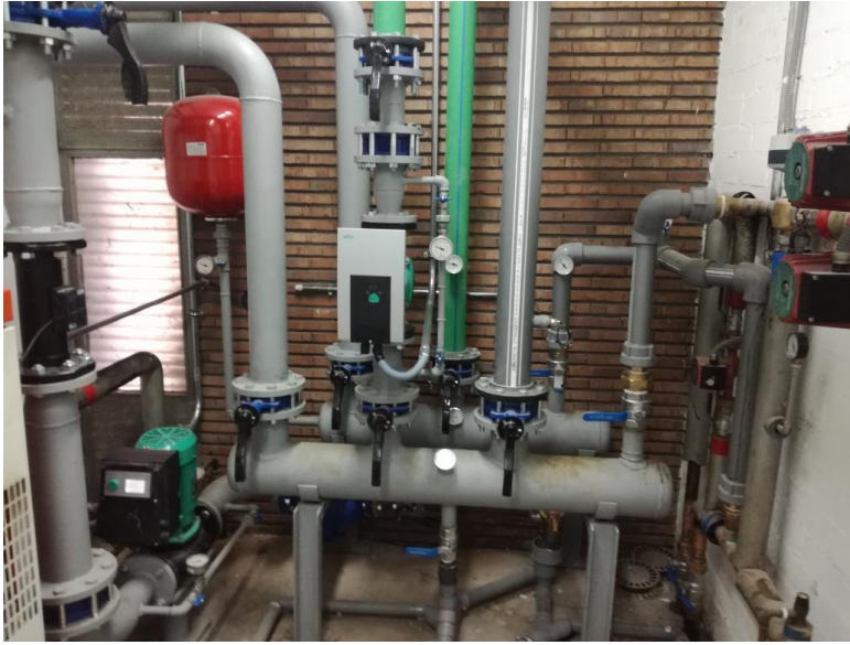
Foto 3. Colector de frío y bombas
