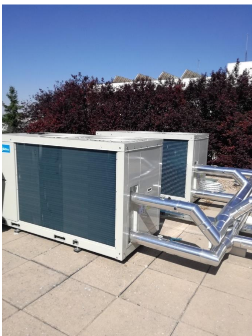
Foto 1.- Enfriadoras situadas en cubierta
