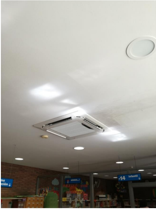
Foto 6.- Equipos interiores en Biblioteca Infantil
